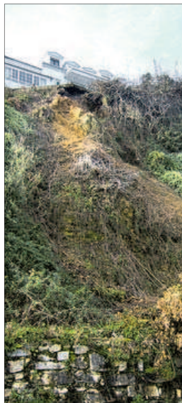
La zona del derrumbe. | T. C.
