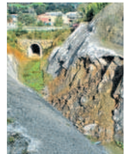
Derrumbe del talud en las obras del ramal de Ence en Navia. | e. g.
