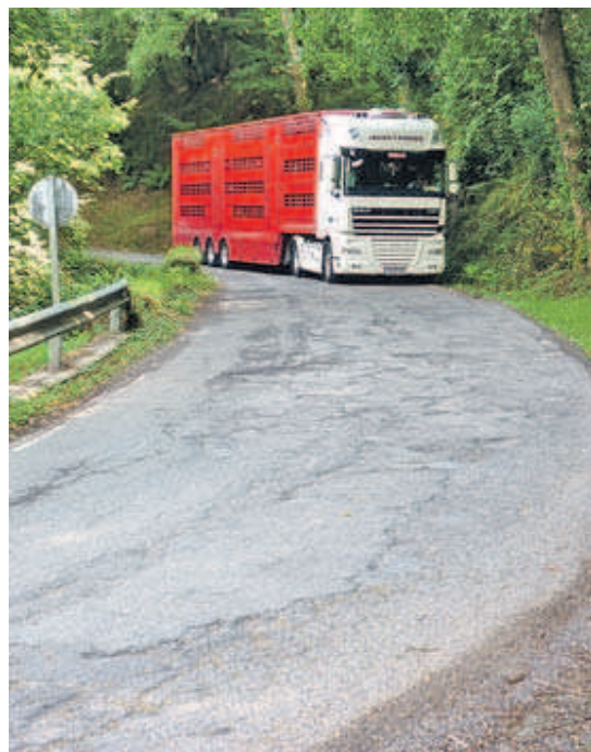
Tramo deteriorado de la carretera de Navelgas, el pasado verano. | D. A.
